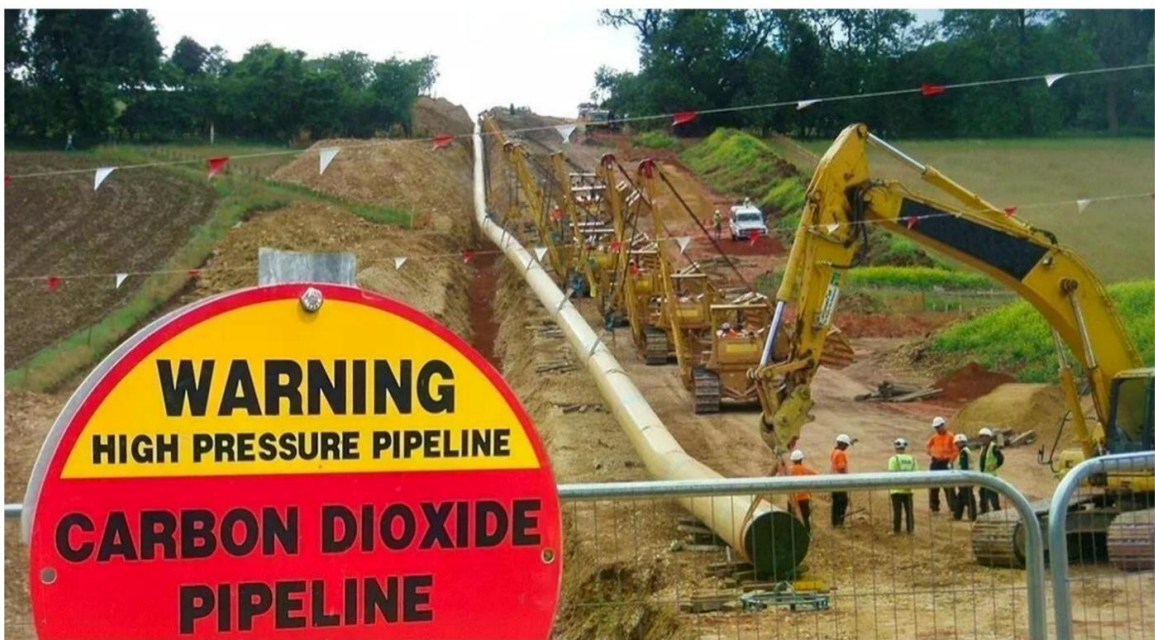
På skiltet står: Advarsel! Rørføring under højt tryk. CO 2 rørføring (kilde: Change.org).
